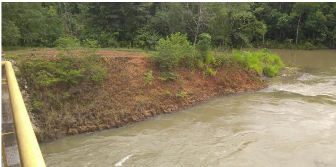
Figura 10 - Enconstas no canal de fuga
